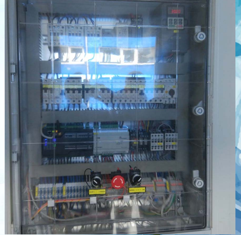
Otomasyon Panosu (Remote Terminal Unit)
